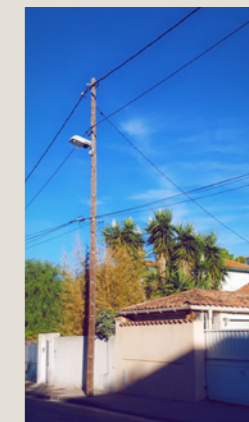
Ligne aérienne avec fibre optique
